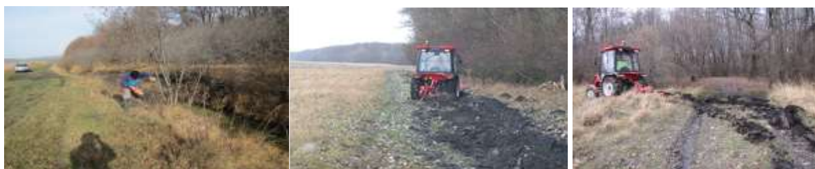
Igienizarea canalului limitrof Pădurii Prejmer; Bandă de protecție împotriva incendiilor și limitare acces lizieră Pădurea Prejmer;
